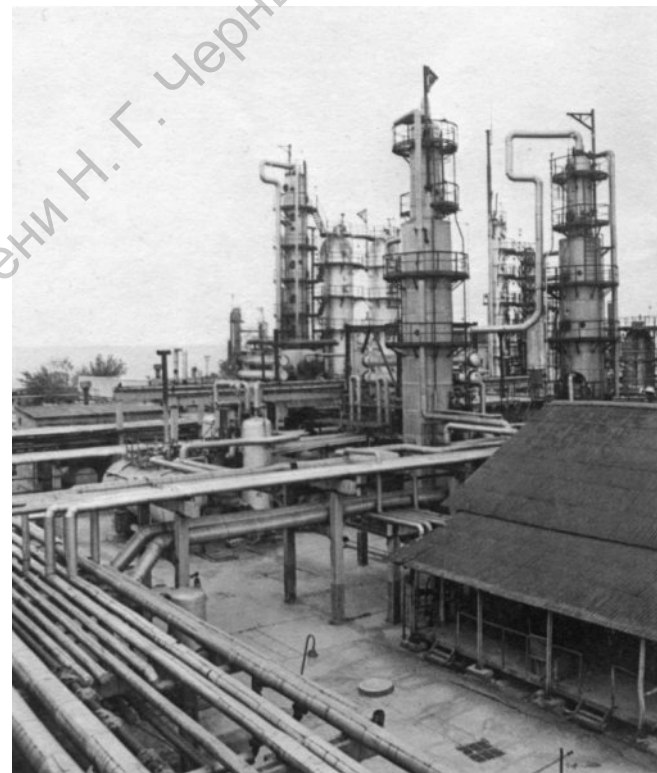
Установка гидроочистки Л-24/6 на Саратовском нефтеперерабатывающем заводе
